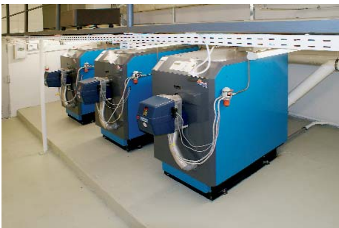
Drei ProCondens-Brennwertkessel, leistungsstark und servicefreundlich installiert
