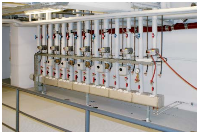
Übersichtlich die Heizkreisverteilung. Der Heizraum ist technisch wie optisch vom Feinsten
