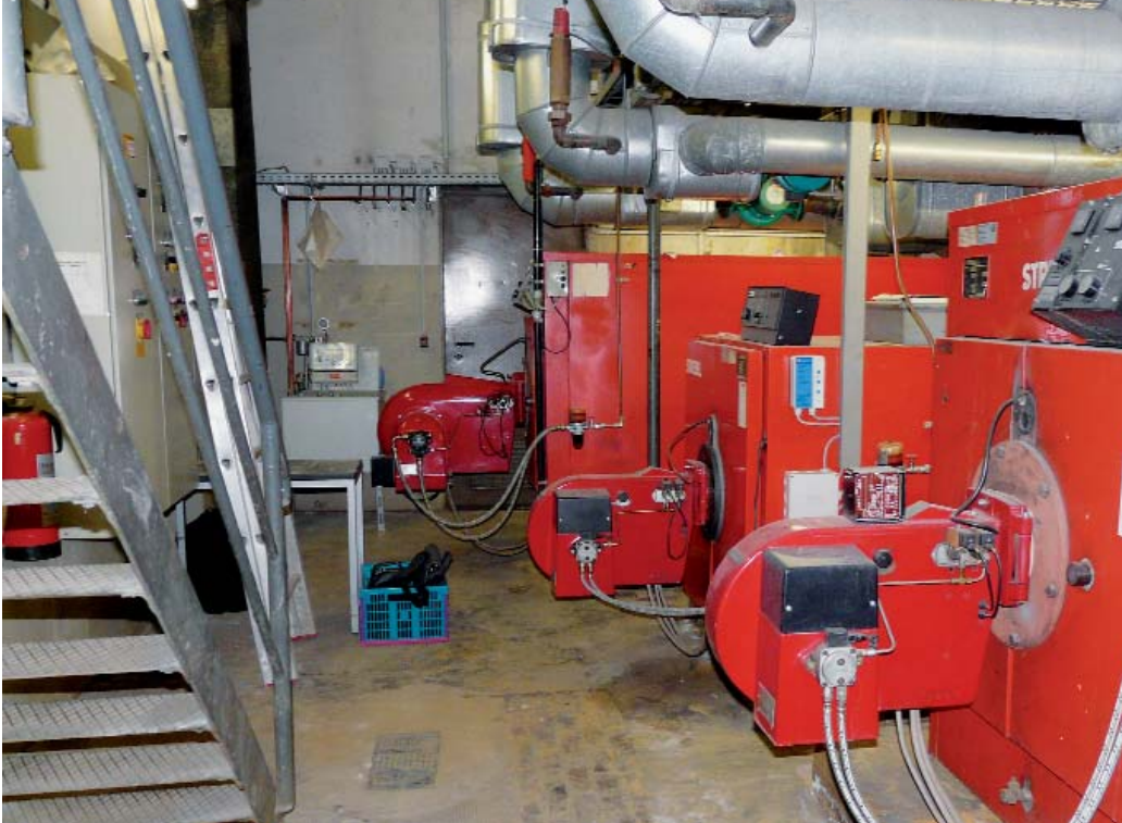
Eine gewaltige Kraftzentrale – aber wenig effizient. Die Sanierung der Heizungsanlage war zwingend.
